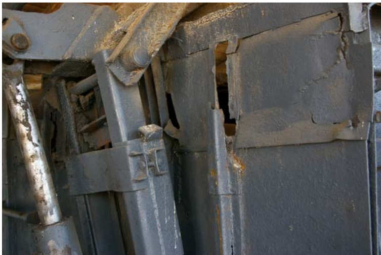
Фото 46 Техническое состояние листовой стали кузова
