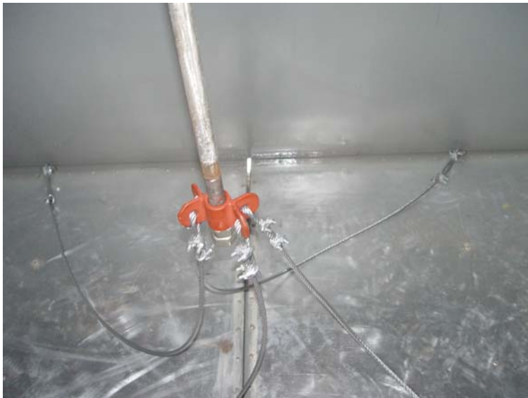
Фото 95 Тросы управления люками
